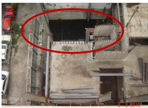
b) Edificio vecinal con problemas de aguas freáticas
