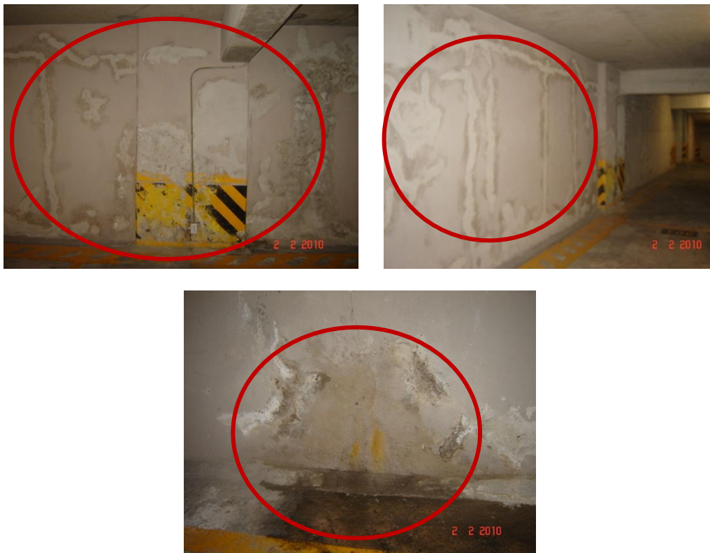
e) Muros de concreto armado con daños por humedad
