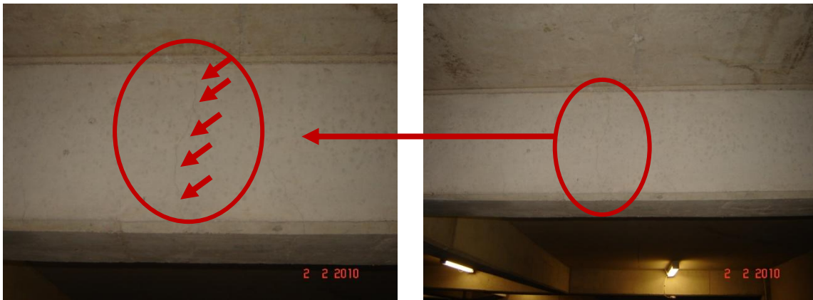
d) Grietas en trabes, Sótano 1
