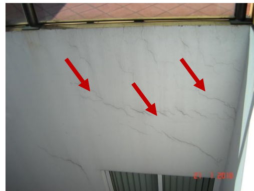
b) Grietas en murete nivel azotea
