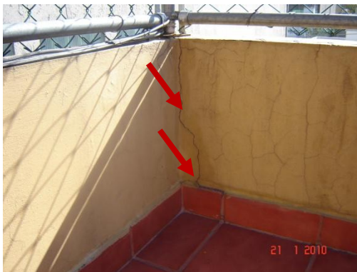
a) Grietas en pretil en una esquina
