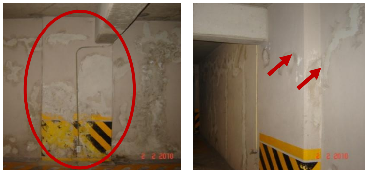
a) Columnas con daños por humedad
