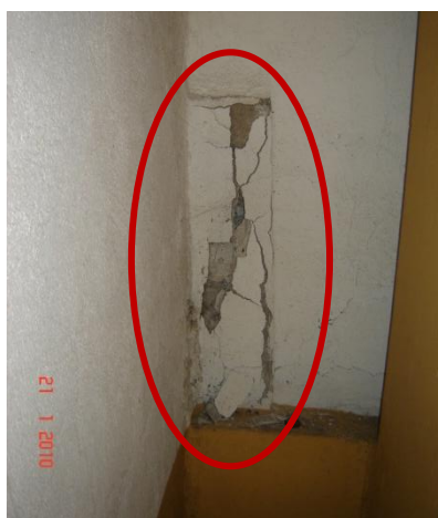
a) Desconchamientos en muro perimetral
